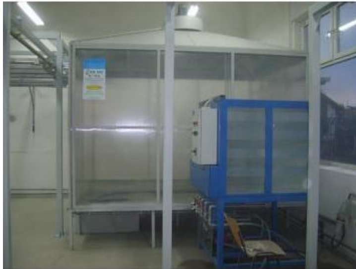
Cabina de pregătire a suprafețelor
